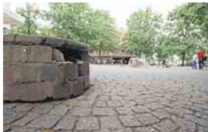
Verwahrlost: Die steinernen Sitzbänke sehen ganz schön alt aus – richtig einladend sind sie nicht mehr.
