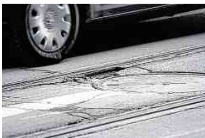
Eine einzige Rumpelpiste: In der Fraunhoferstraße gibt es keine zehn Meter ohne massive Straßenschäden. Foto: Hansi Trompka
