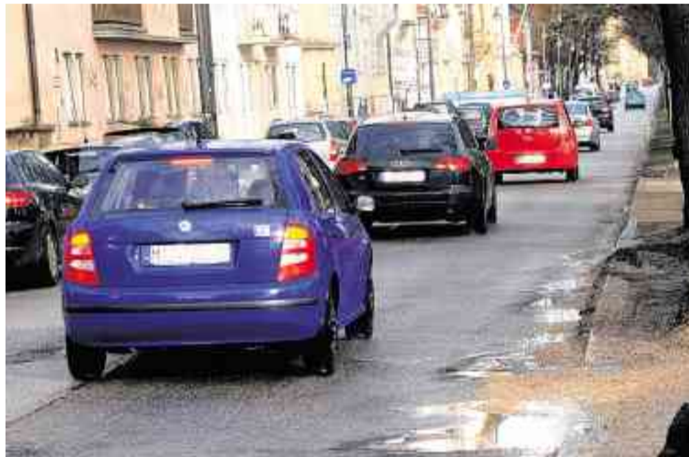
Am besten Schlangenlinien fahren: Schlaglöcher in der Wittelsbacherstraße.
